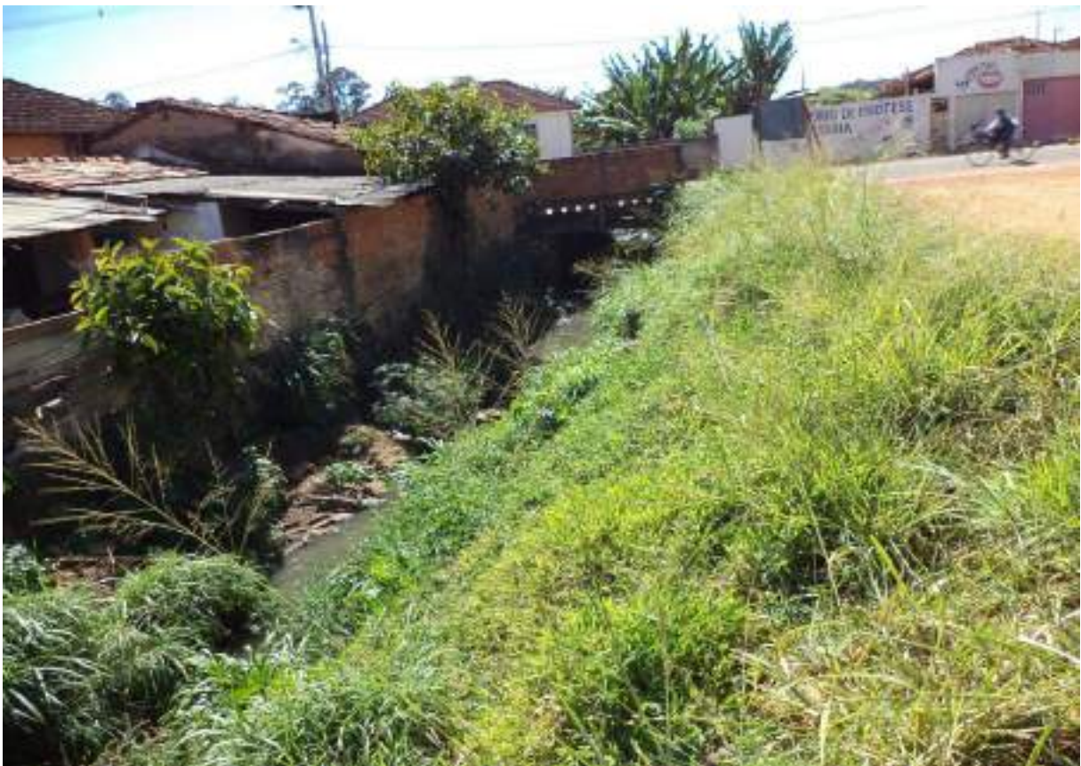
Foto: Ponto de alagamento, travessia sobre o Córrego Olaria, Rua Delfim Moreira.
