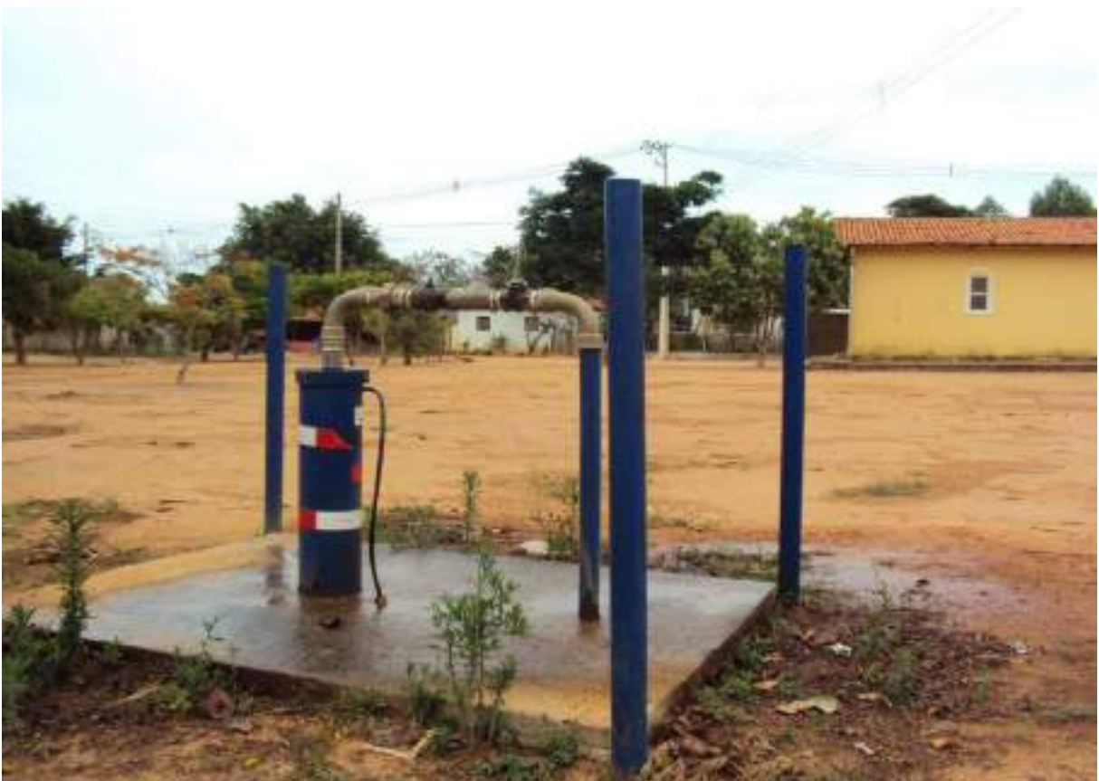
Foto: Poço profundo do Povoado dos Perdizes.
