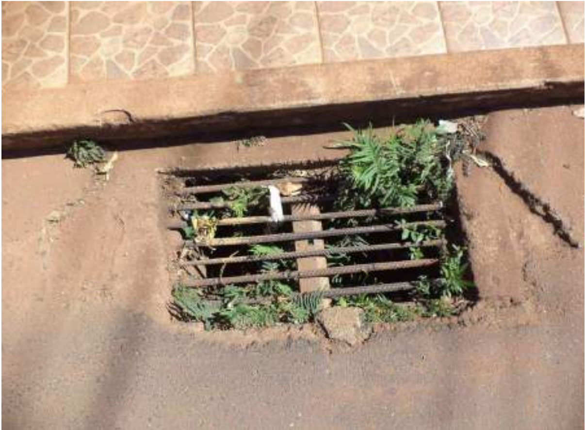
Foto: Boca de lobo sem manutenção.
