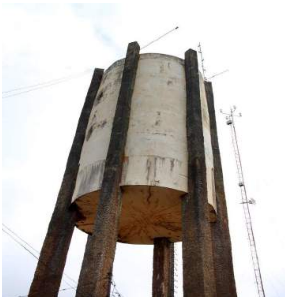
Foto: Reservatório R2 Lagoinha desativado por apresentar vazamento em sua estrutura.
