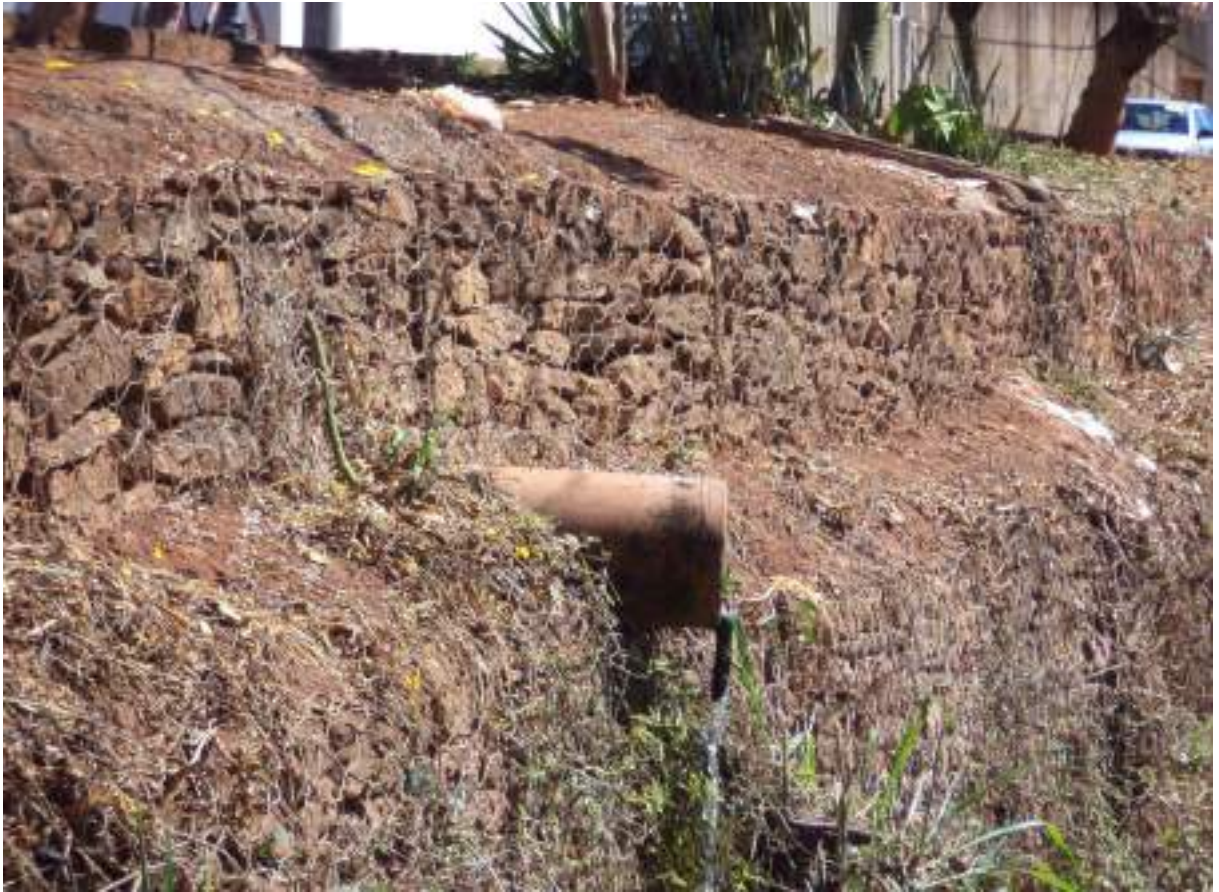
Foto: Lançamento de esgoto no Córrego Mumbuca.
