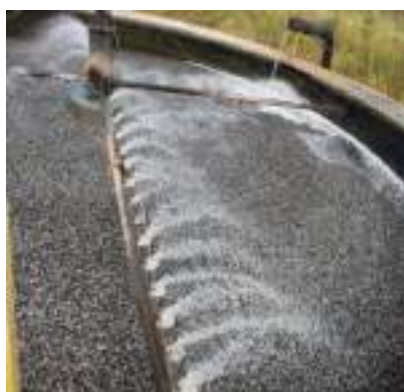
Foto: Filtro Biológico da ETE
