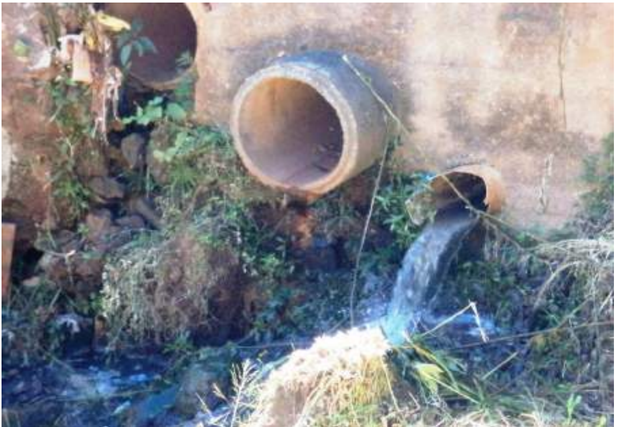
Foto: Lançamento de esgoto no Córrego Mumbuca.
