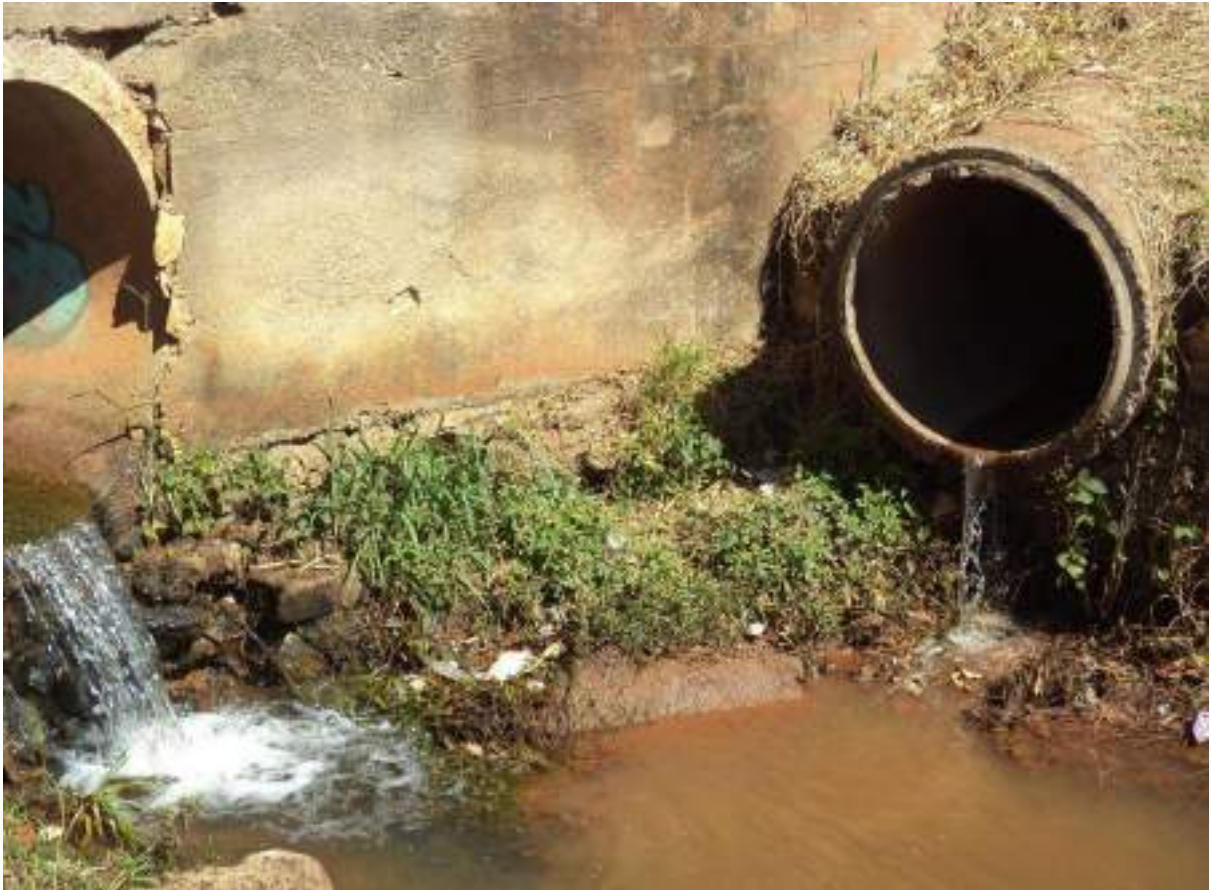
Foto: Galeria de água pluvial com esgoto clandestino lançado no Córrego Mumbuca
