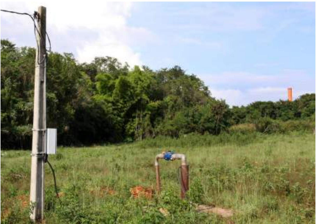
Foto: Poço profundo Morada Nova II (P21), sem as devidas proteções de segurança.
