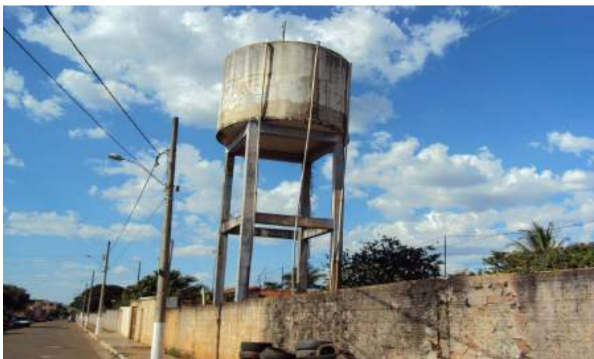
Foto: Reservatório R6 Avenida Romualdo Resende.
