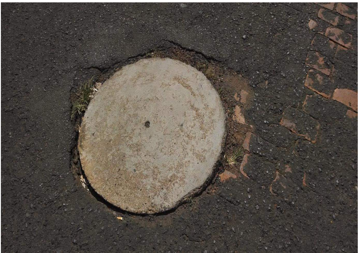
Foto: Poço de Visita padrão DMAE com tampa de concreto.
