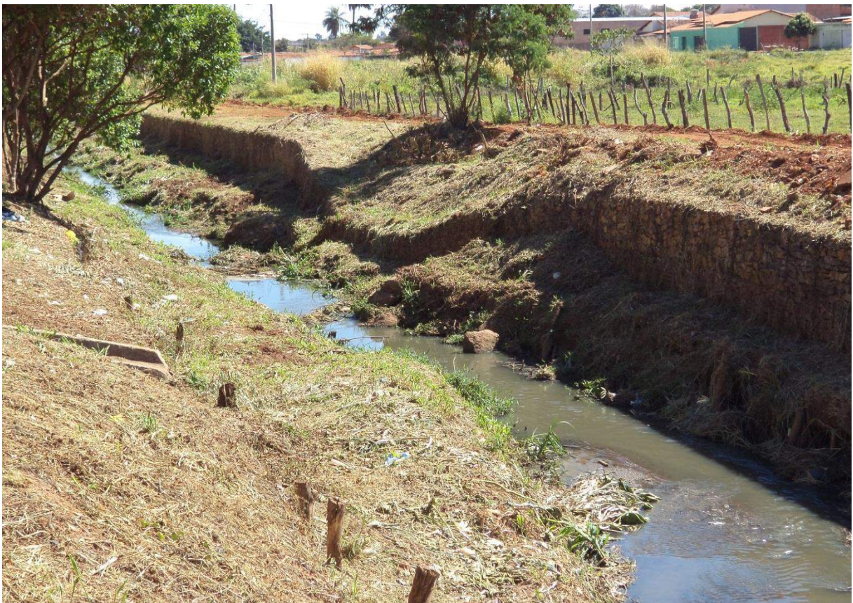
Foto: Talude em gabião do Córrego Mumbuca rompido.
