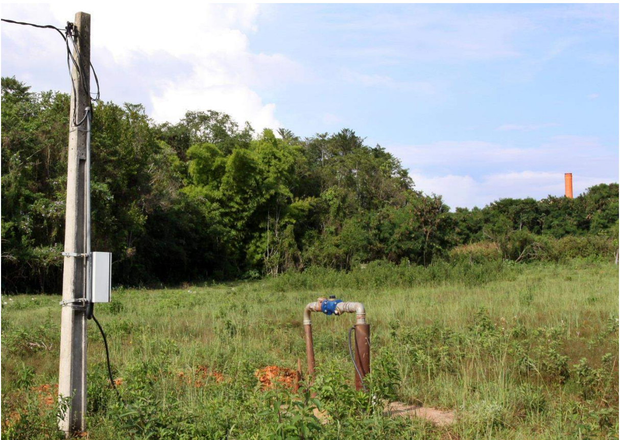
Foto: Poço profundo Morada Nova II (P21), sem as devidas proteções de segurança.
