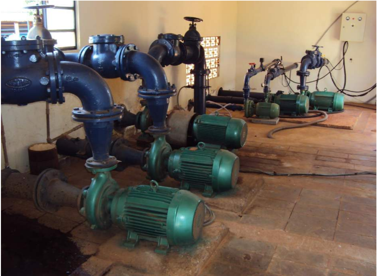
Foto: Estação elevatória de água tratada da ETA Mumbuca.
