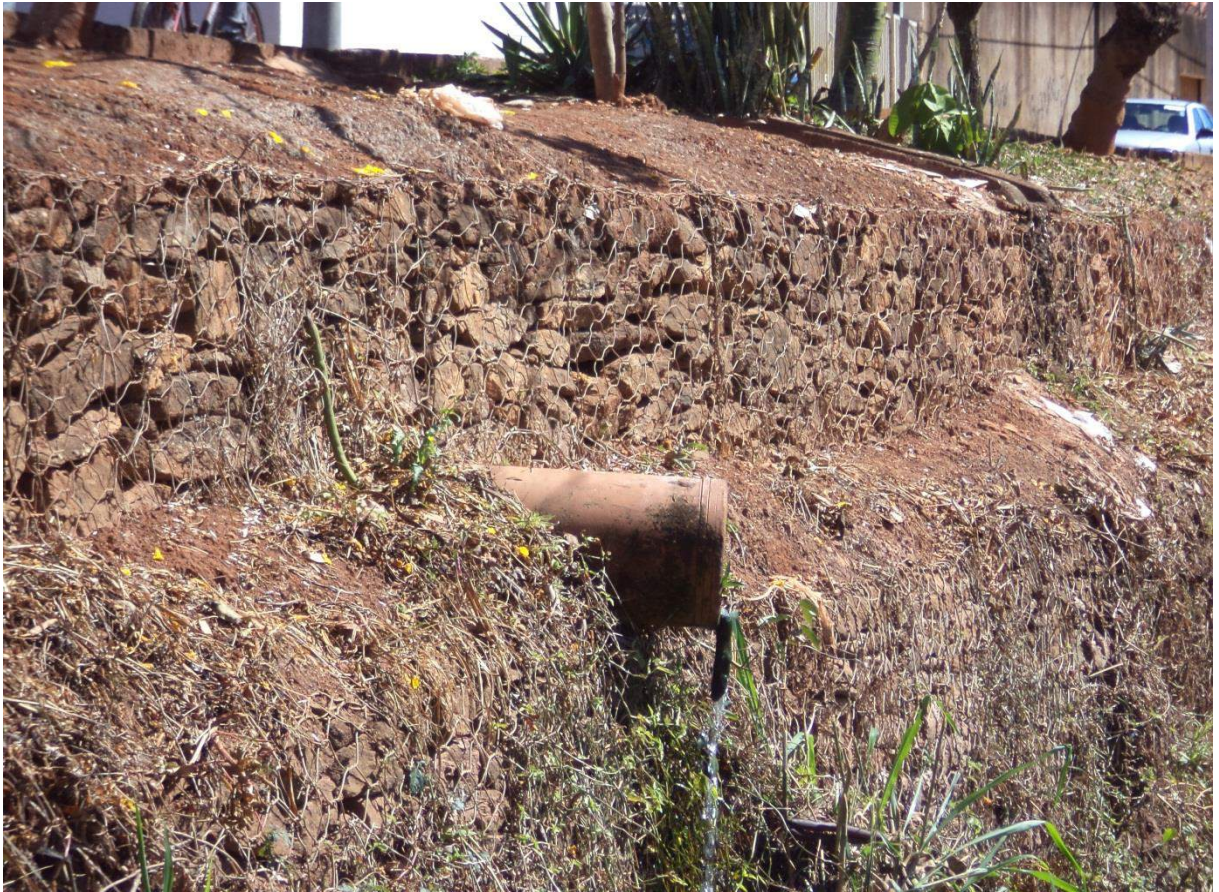
Foto: Lançamento de esgoto no Córrego Mumbuca.
