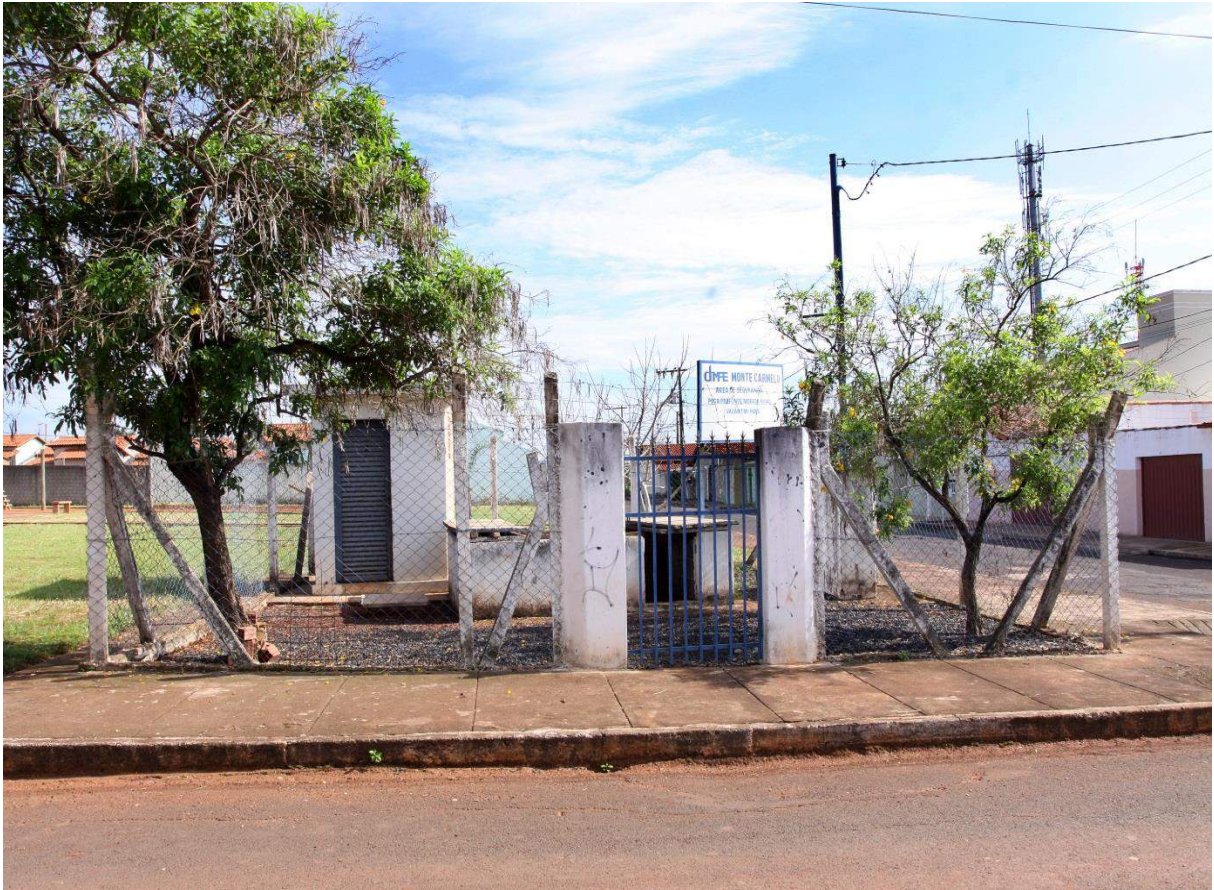
Foto: Poço profundo Morada Nova I (P9), devidamente protegido com cerca e larje de concreto.
