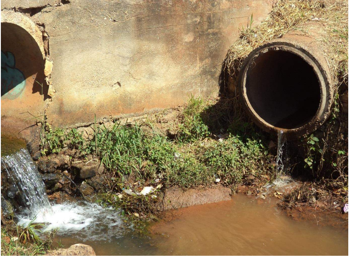
Foto: Galeria de água pluvial com esgoto clandestino lançado no Córrego Mumbuca
