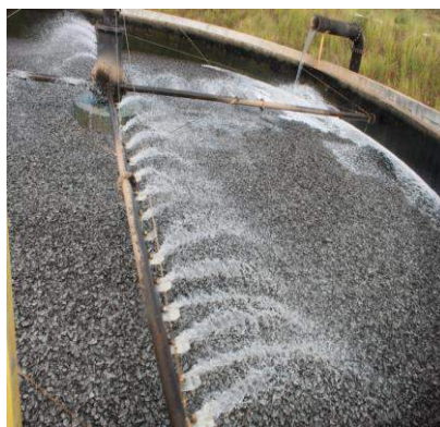
Foto: Filtro Biológico da ETE
