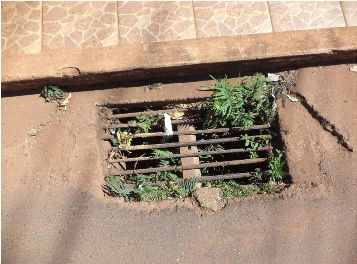
Foto: Boca de lobo sem manutenção.
