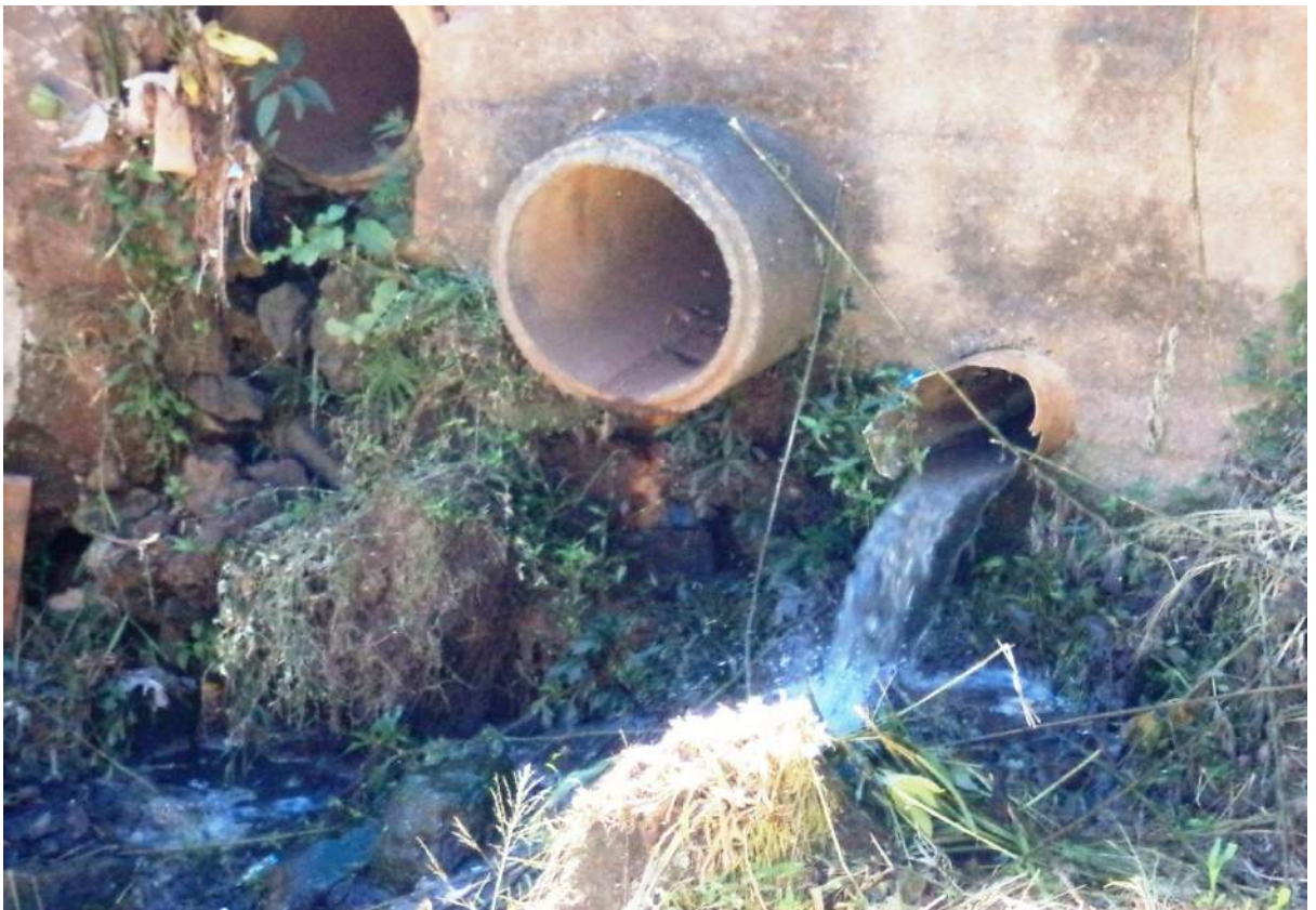
Foto: Lançamento de esgoto no Córrego Mumbuca.
