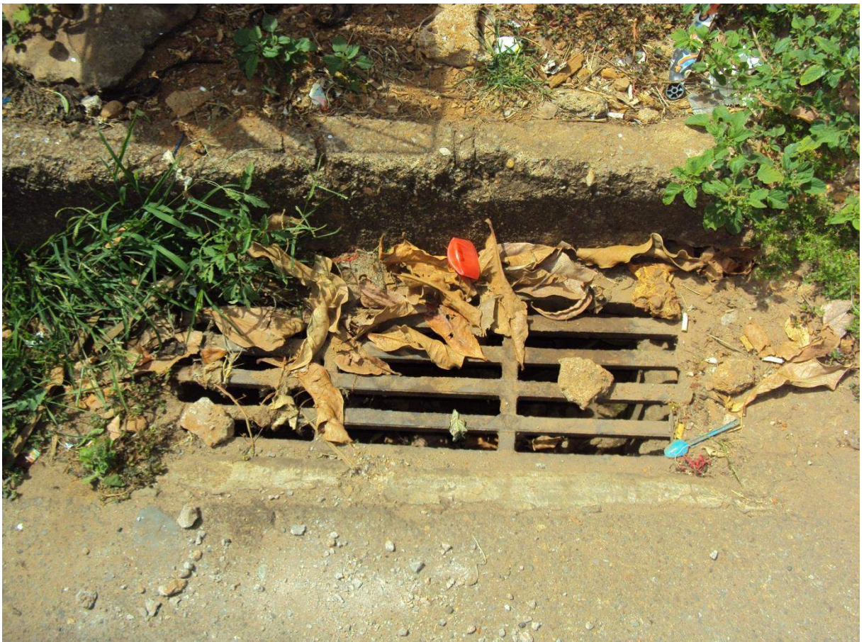
Foto: Boca de lobo no Bairro Vila Nova.
