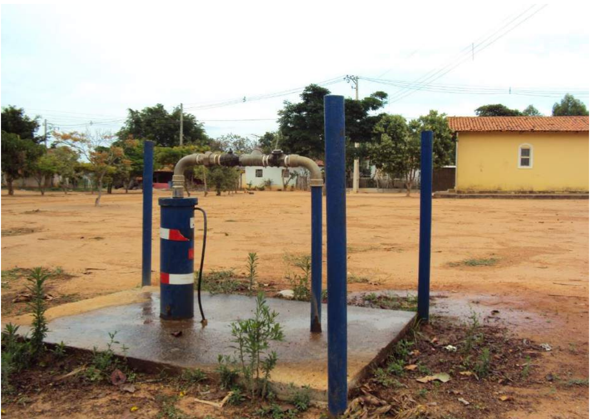
Foto: Poço profundo do Povoado dos Perdizes.
